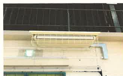
【体育館に設置された空調設備の一部】
