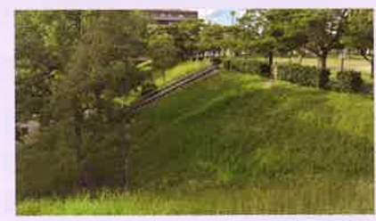
現在の斜面の状態
