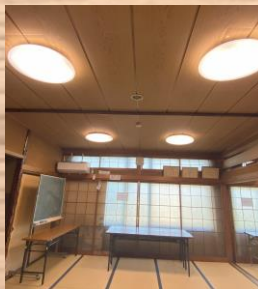
2F和室LED照明
