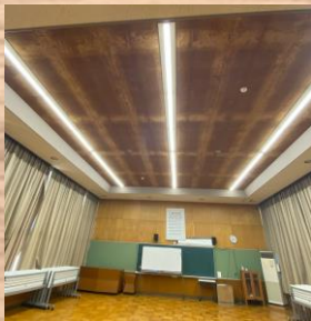
1F遊戯室LED照明
